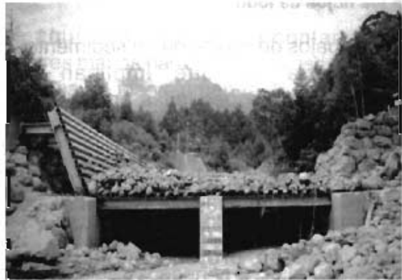
Fotografía 9. Presa cribadora de rejilla horizontal, donde se detiene bruscamente el material rocoso al ser filtrada el agua con esta estructura, cuando llega el frente del flujo de lodo
