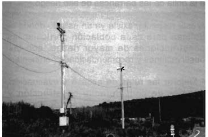
Fotografía 20. Altavoces colocados en lugares estratégicos, de tal manera que la población pueda escuchar claramente los mensajes de prealerta y alerta en caso de ocurrencia de flujos de lodo provenientes de la parte alta del volcán
