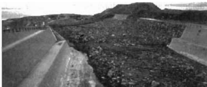
Fotografía 13. Trabajos de remoción de escombros, donde se remueve el material acumulado, ya que es importante tener en buen estado estas estructuras para el caso de flujos inesperados
