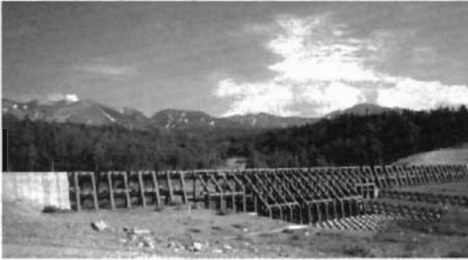
Fotografía 6. Presa cribadora de rejilla vertical con estructura de acero, para detener los grandes bloques de roca que viajan dentro de los flujos de lodo
