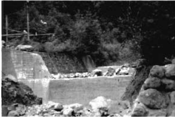
Fotografía 19. En esta estructura se observan tres juegos de sensores de alambre (3 alambres en cada juego) energizados, cuya función es emitir una señal en caso de ser rotos al pasar un flujo de lodo
