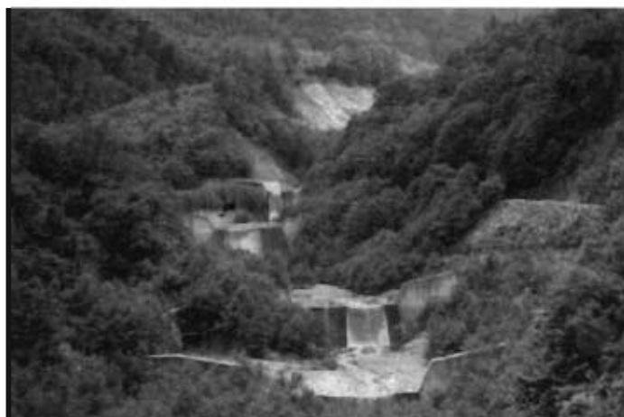
Fotografía 4. Trabajos de consolidación para evitar el movimiento y arrastre de sedimentos inestables de los lechos, en arroyos y barrancas
